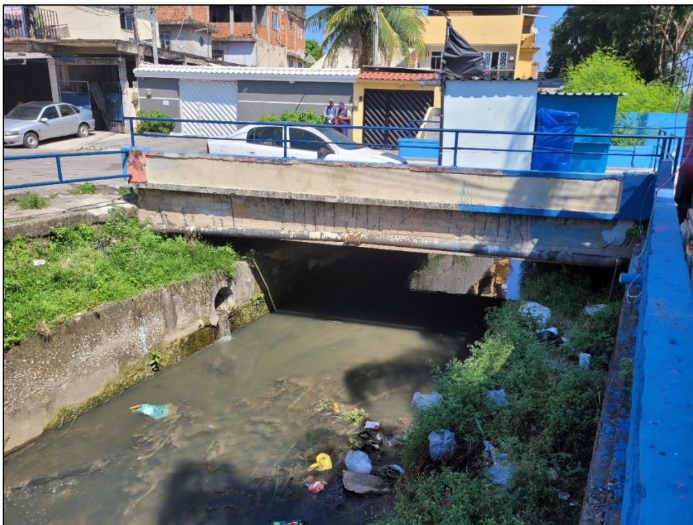
Figura 27 – Macro drenagem recebendo esgoto na altura da ponte da Rua Marechal Deodoro, Bairro Nova Cidade.
