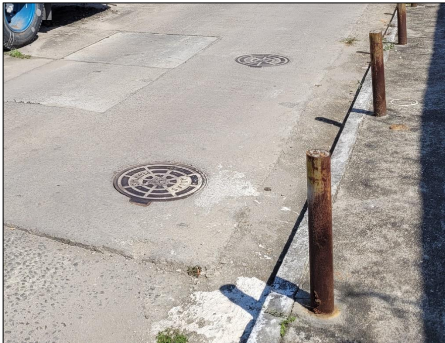
Figura 39 - Dispositivo de drenagem.
