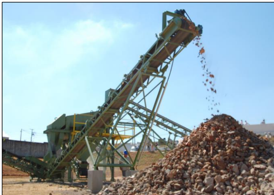
Figura 52 - Usina fixa de RCC.
