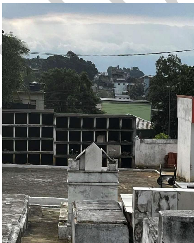
Prédio de gavetas não utilizadas (necessita adequação)
